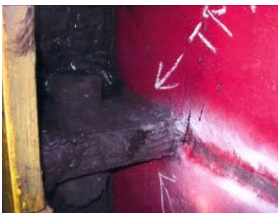
Трещина в сварных швах ребра жёсткости
